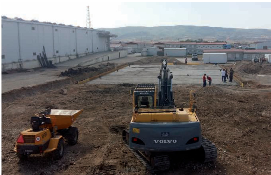
Kein Haus steht ohne gutes Fundament, das ist bei dem Bau der NSE (National Support Element) im Camp Novo Selo nicht anders.
